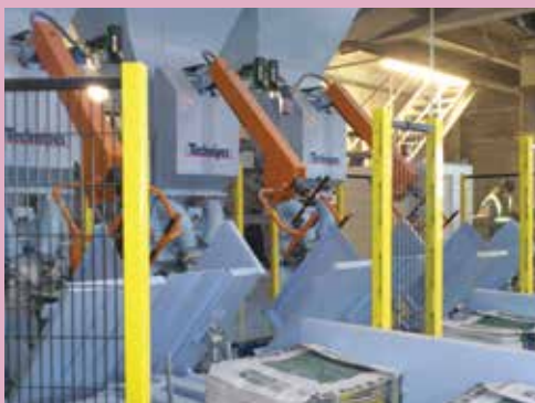
Stazione insacco a 3 bocche - PAREX (Florida USA) Three-spout bagging system - PAREX (Florida USA) Ligne d'ensachage à trois becs - PAREX (Floride USA) Estacion de embolse a 3 bocas - PAREX (Florida USA)
